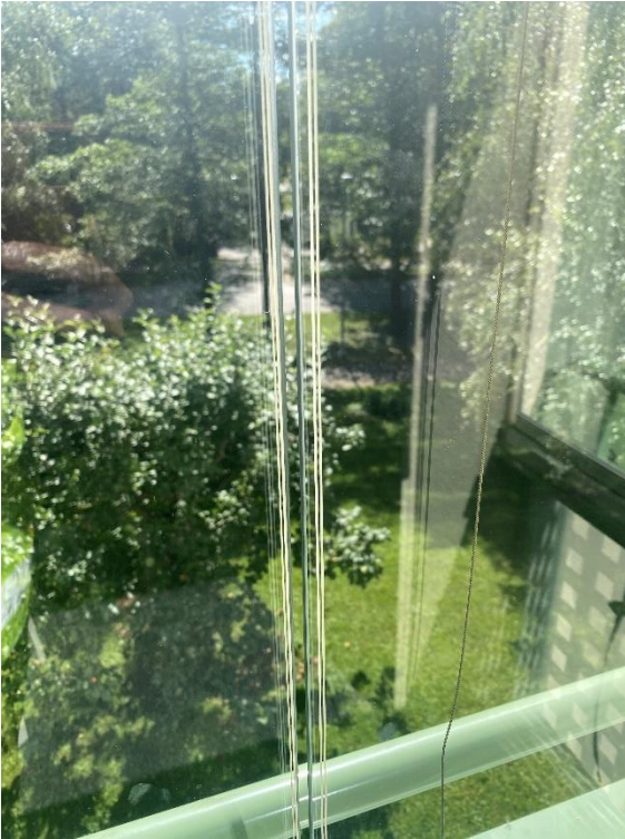
Kuva 7 Lasituksien välissä on huomattavia aukkoja
